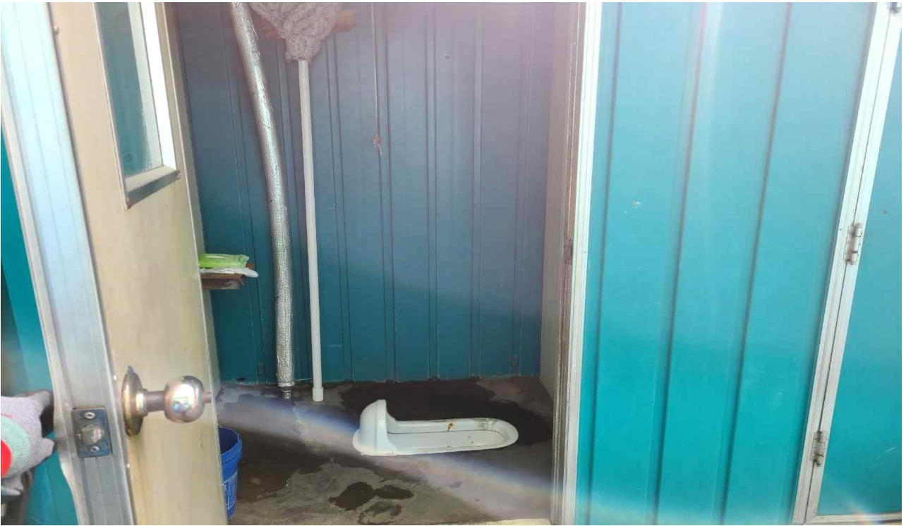
실제 사례 사진 : 구식 화장실 및 수도 시설 없음
