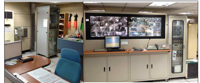
<그림 11> 구의역 역무실의 승강장안전문 종합제어반, 경보제어반, 모니터
